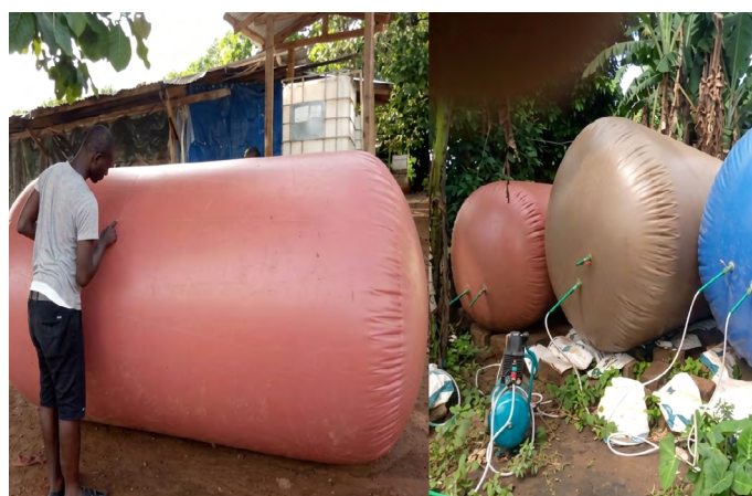
Stockage de biogaz
